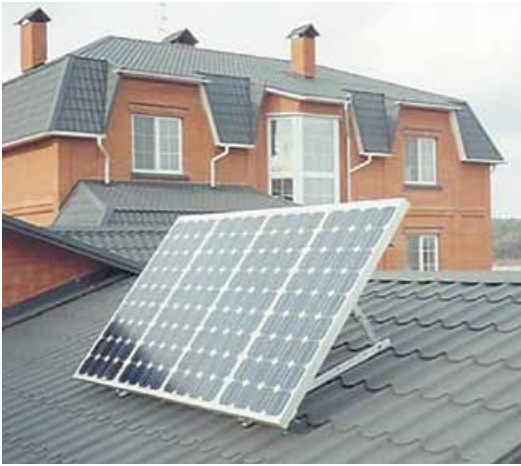
Мал. 48. Сонячні батареї на даху будинку
